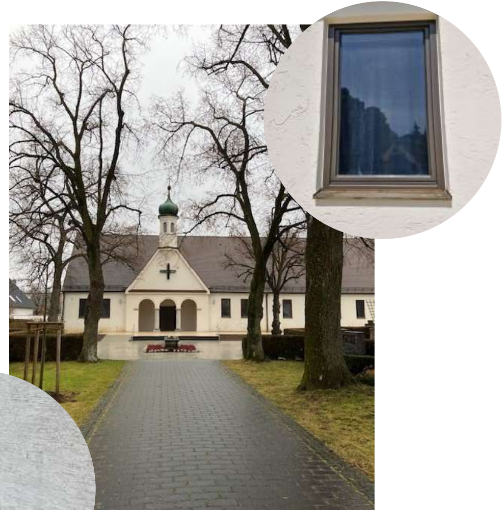
Ausbrüche an FH Mauer
